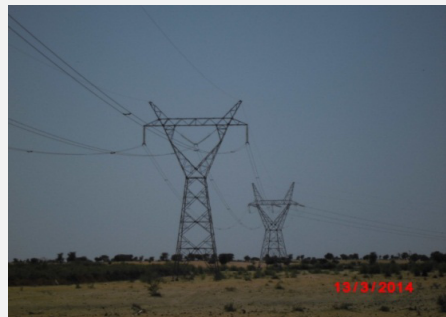
Figure 1.27. Lignes à Hautes Tension qui traversent plusieurs zones humides dans le bassin du fleuve Sénégal (Hamallah Diagona)
